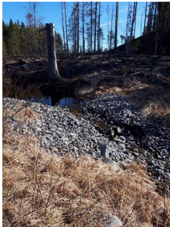
Översta tröskeln har tätat sig själv och vattnet rinner över precis som det ska. 5/5 2020.
