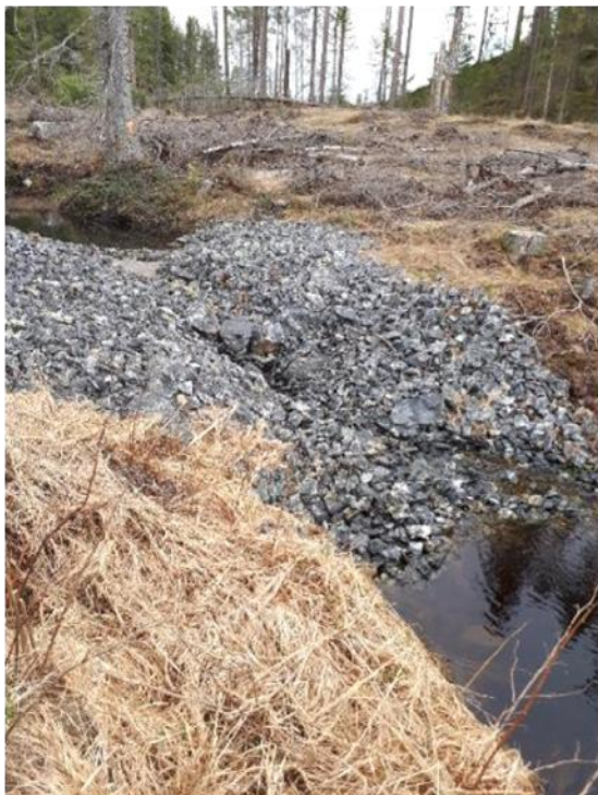
Översta tröskeln 7/5 2019. Tröskeln dämmer upp men vattnet rinner igenom istället för över.
