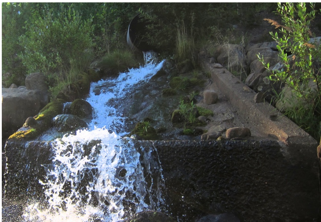
Figur 1: Rismyrbäckens utlopp mot Rickleån går över en betongkonstruktion som ska skydda mot erosion. Konstruktionen skapar ett definitivt hinder för fiskvandring. (Trumman är utbytt sedan bilden togs). Foto: Jan Åberg.
