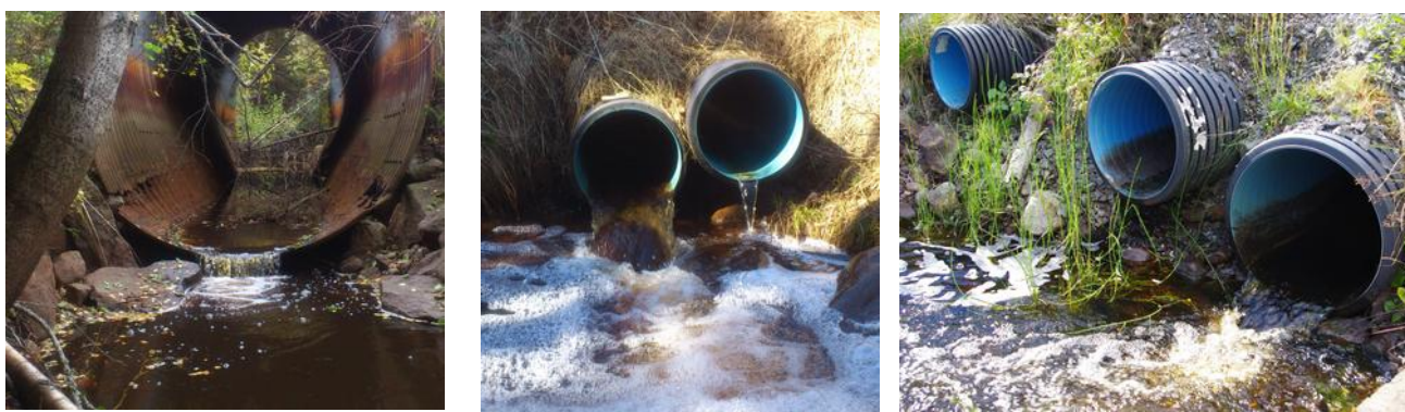
Figur 18. Vägtrummor är i ett flertal fall hindrande för fiskvandring.
